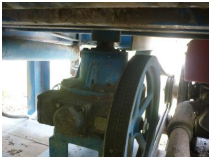
Prevodová skriňa pod miešacou časťou
